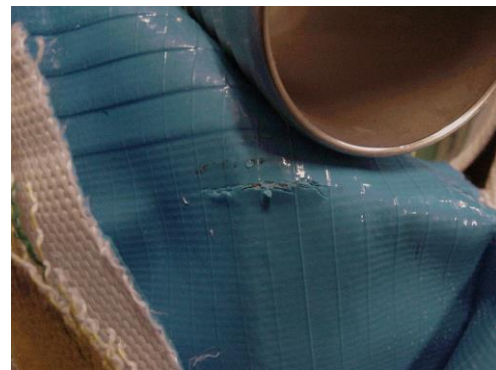
金具の角で内張りが切れた状態
