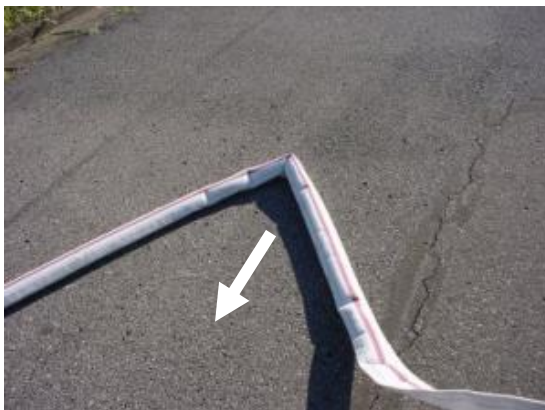
消防用ホースがV字になった状態
